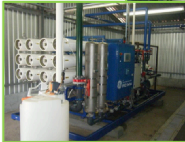
Planta de osmosis inversa Cap: 200 galones por minuto de agua tratada
