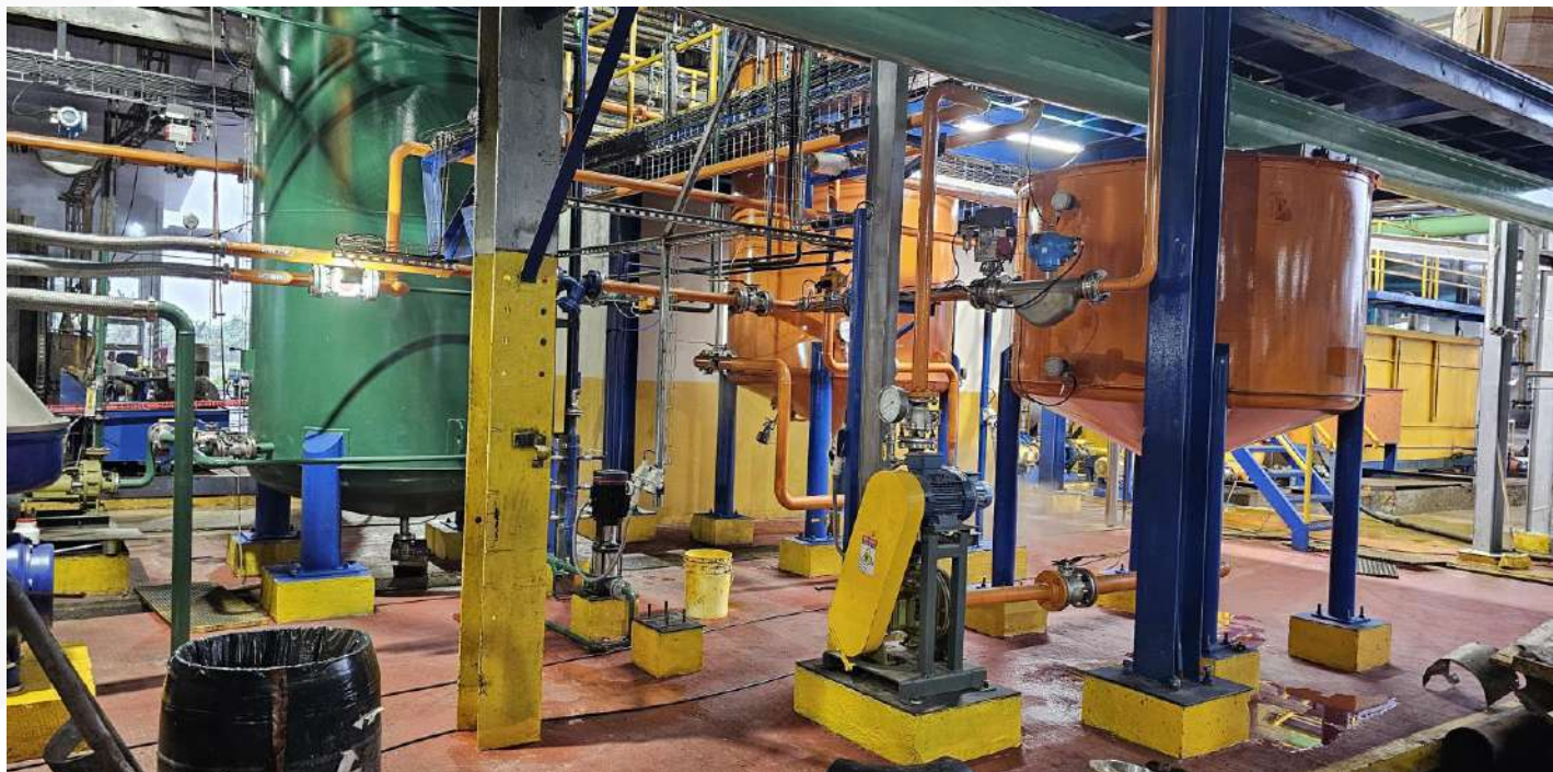
Tanque de agua de operación Osmosis
