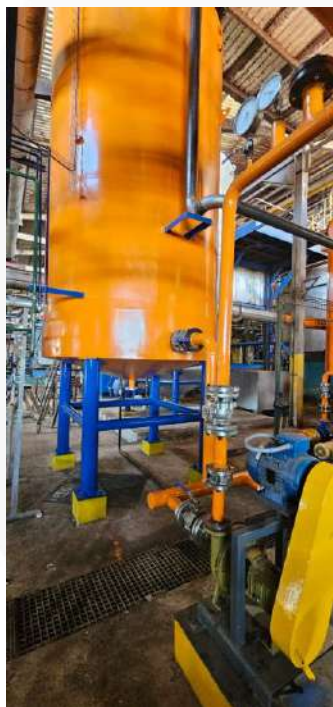
Tanque Pulmón Planta de Lavado
