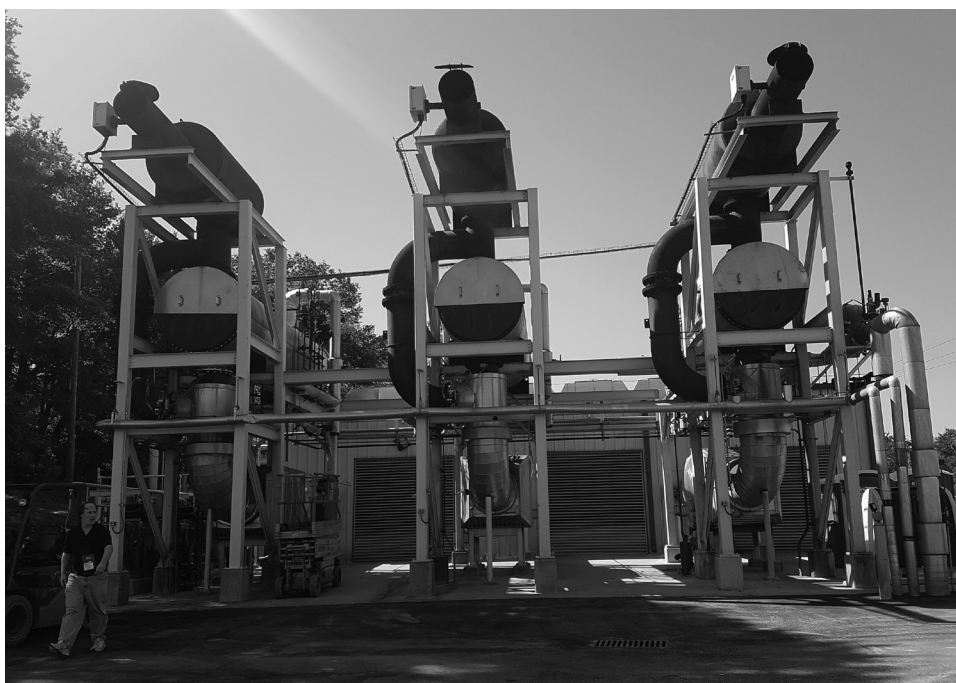
Producción de calor y frío a través de biogás en la planta de Coca-Cola en Atlanta
