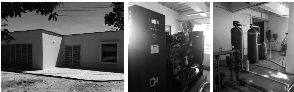
FIGURA 66. Área técnica sede principal
