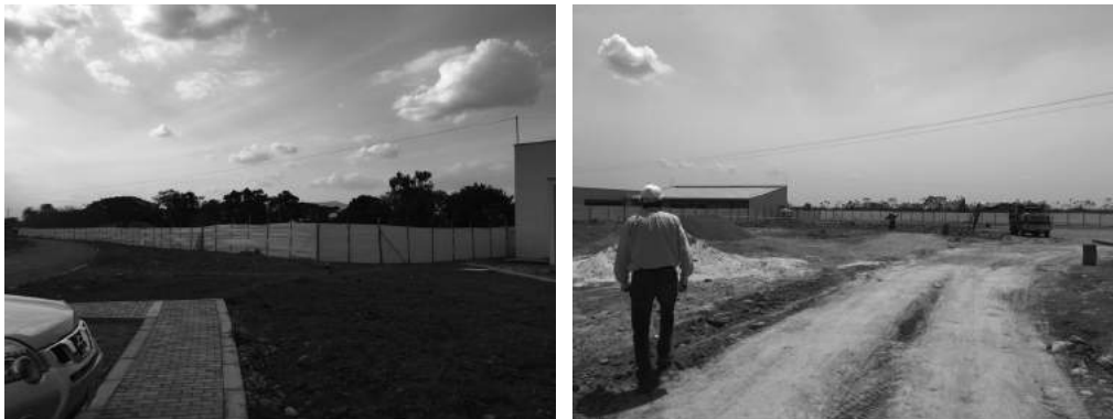
FIGURA 70. Cerramiento y descapote del área para la construcción del módulo de laboratorios
